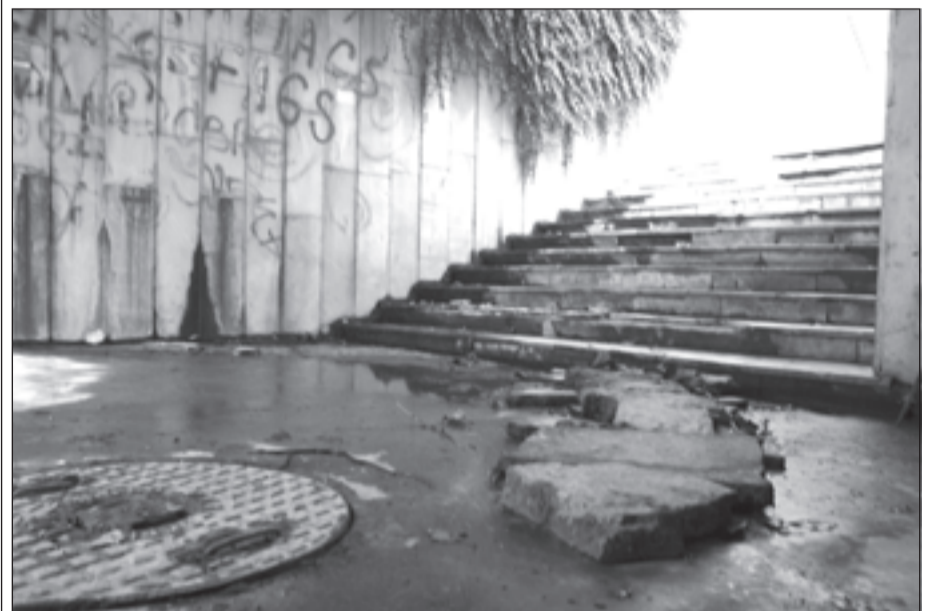
Мазилката по тавана и стените на подлеза „Почивка“ глаче за ремонт. Кметската администрация се съмнява, че причина за рушенето е отходна яма, изградена за нуждите на един от хотелите в съседство. Снимка Мирослав Кунев
